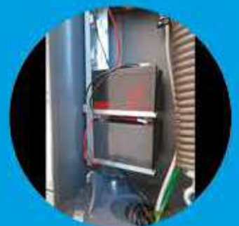
Batterijen voor noodwerking
