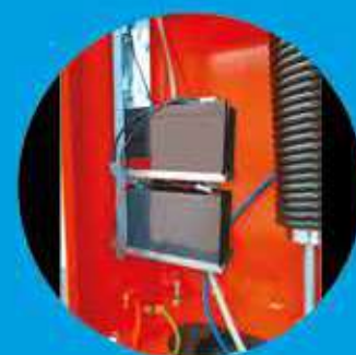
Batterijen voor noodwerking
